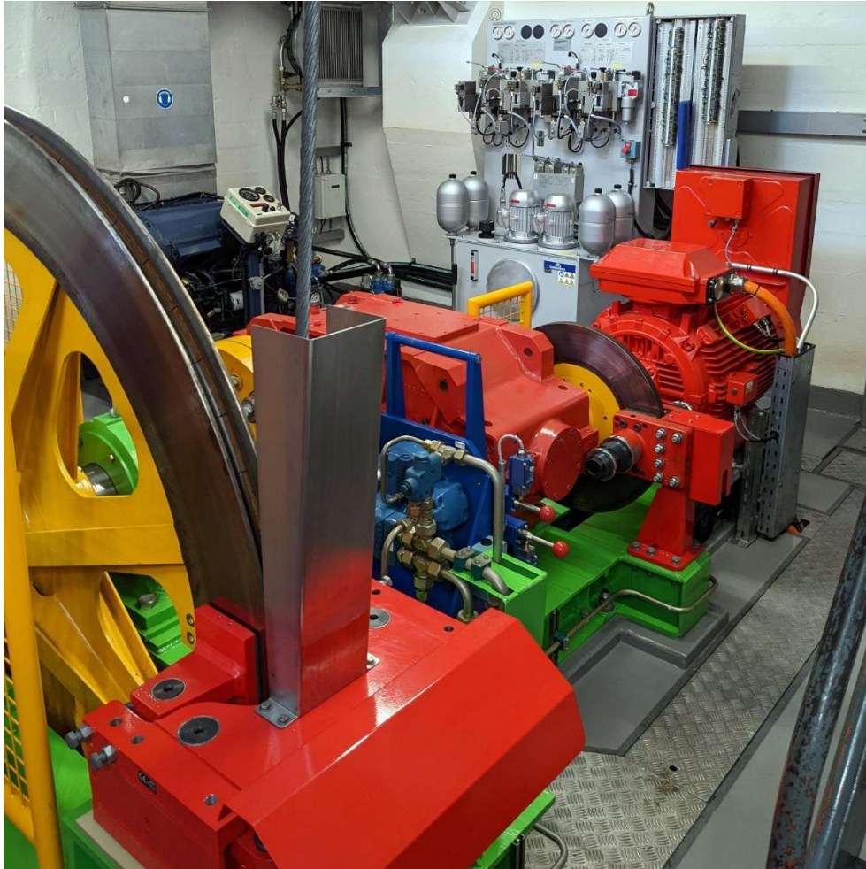
Blick in den Maschinenraum mit den neuen Bremsen und dem neuen Bremshydraulikaggregat.
